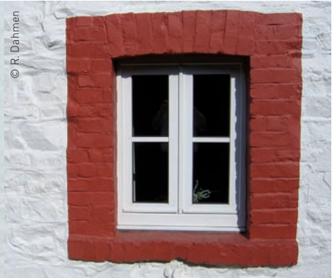
© R. Dähmen Die Verglasung des Sprossenfensters wirkt durch den breiten Rahmen zu klein. Diese Unterteilung ist nicht für kleine Fensteröffnungen geeignet
