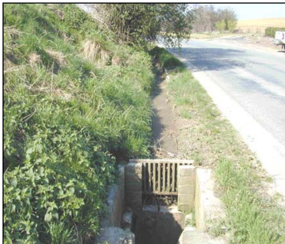
Figure 68 – Fossé collecteur obstrué par les dépôts de boue (Photo S. Dautrebande).
