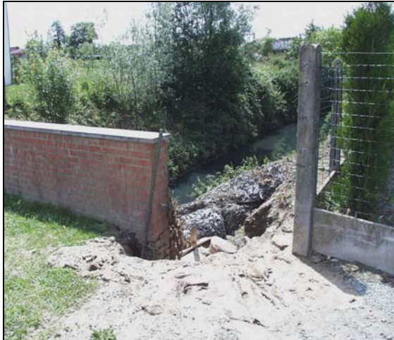
Figure 67 – Dégâts des eaux et des boues aux infrastructures (plus érosion de la berge du cours d'eau au point ayant servi d'exutoire aux flots boueux) (Photos S. Dautrebande).
