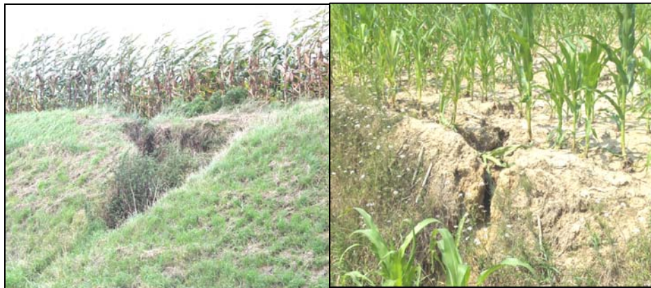
Figure 6 – (a) et (b) Effondrements de talus en bordure de parcelle agricole (Photo (a) S. Dautrebande et Photo (b) Fr. Colard pour S. Dautrebande).
