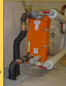
Echangeur de chaleur du consommateur final
